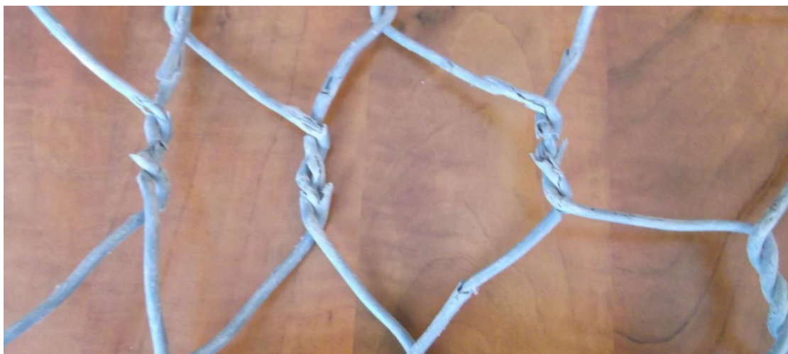
Obr.1 Dvojjákrutová šesťhranná sieť s poškodeným poplastovaním
