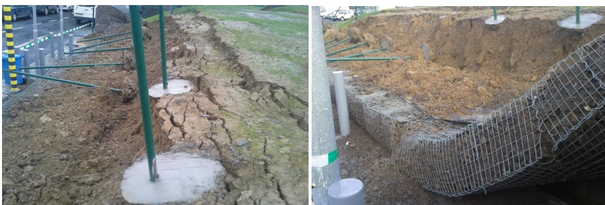
Obr.: Nevhodná voľba GTX a nezabezpečenie proti prívalovému dažďu nad múrom
