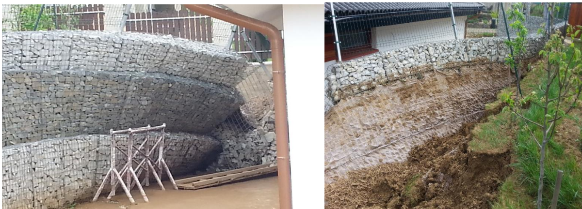
Obr.: Deštrukcia a strata stability hydraulickým tlakom za múrom
